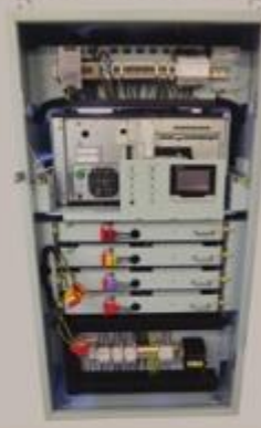
20kVA DEFSTAN AC UPS
